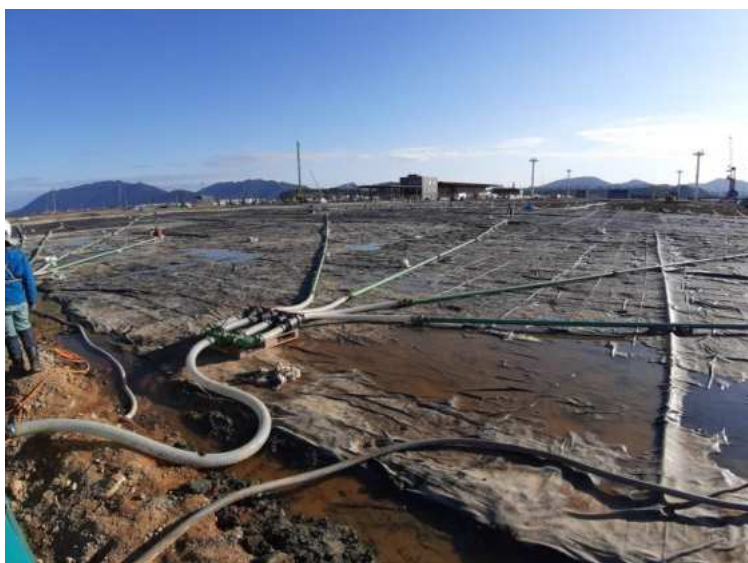
シート上配管
